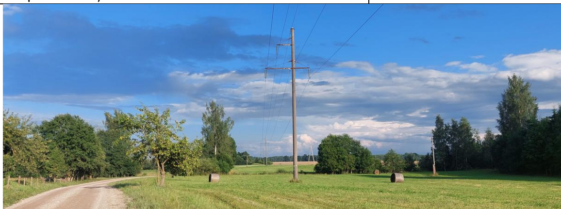
Esošā 110 kV elektrolīnija nepilnus 2 km pirms Vārmes ziemeļu pusē.
