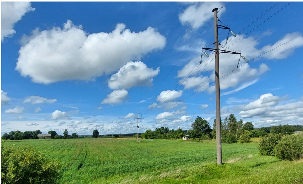
Esoša 110 kV EPL netālu no Zlākām.
