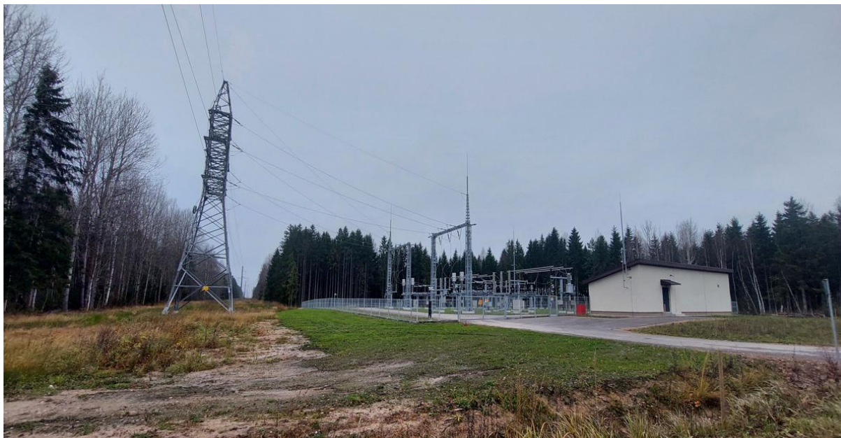
Skats uz esošo apakšstaciju "Vārme". Paredzētās darbības ietvaros plānots apvienot kreisajā pusē esošo 110 kV elektrolīniju ar plānoto 330 kV līniju, izvietojot tās uz režģotajiem metāla balstiem.
